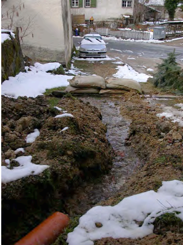
Das in den Sägekeller eingedrungene Wasser wird durch einen notfallmässig errichteten Drainagegraben ins Freie geleitet.
