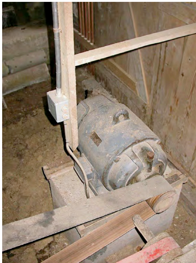
Da das Wasserrad zu klein dimensioniert ist, muss beim Sägen ein elektrischer Hilfsmotor zugeschaltet werden.
