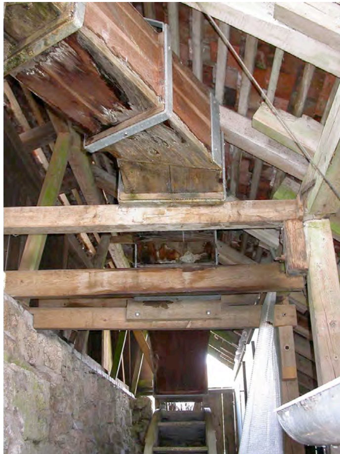
Das Wasser vom Überlauf der Gallislochquelle wird in diesem Kanal von oben auf das Wasserrad geleitet.
