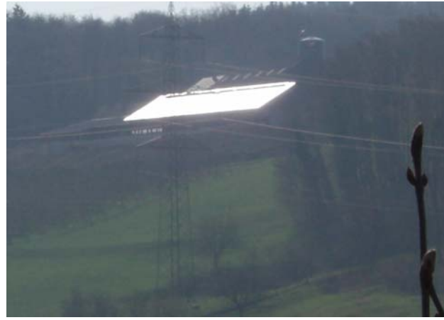
Foto 4: Scheunendach (ohne Solaranlage) mit Blendwirkung.
