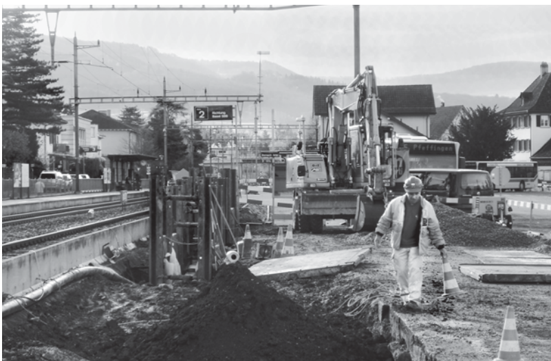
So sah es während den Vorarbeiten für das neue SBB- und BLT-Perron am Bahnhof Dornach-Arlesheim aus.
