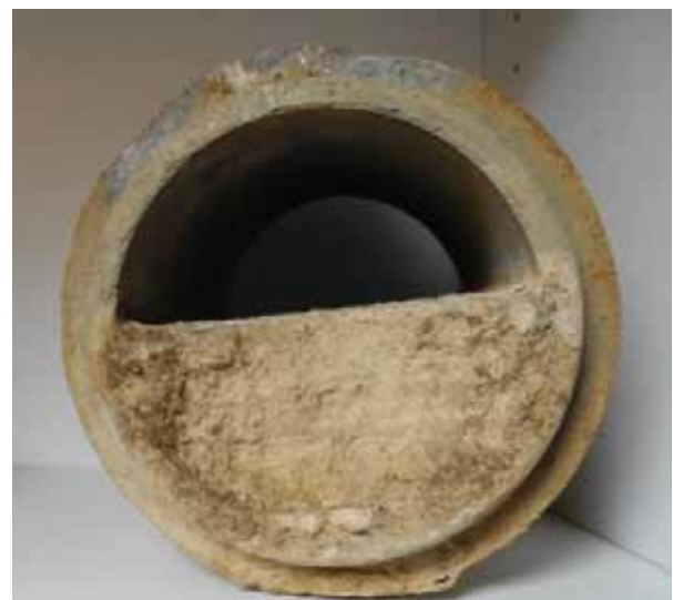
Eine gut zur Hälfte mit Ablagerungen verstopfte Ableitung.
