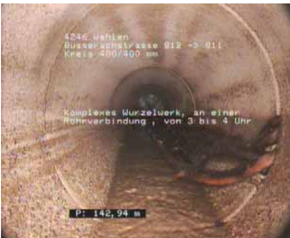
Bei Kanal-TV festgestelltter Wurzeinwuchs, Wahlen (Quelle: Arpe AG)
