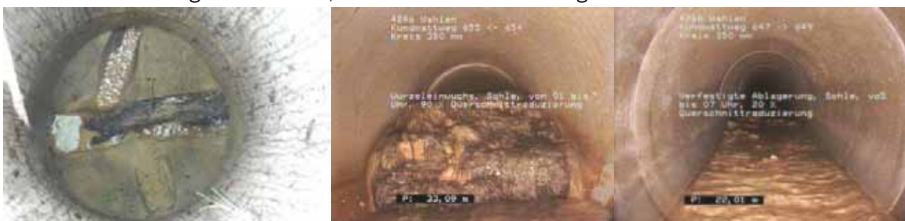
Wurzeln (links und mitte) sowie Ablagerungen (rechts) können Leitungen und Schächte verstopfen und die Abflusskapazität verringern. (Quelle: Arpe AG)
