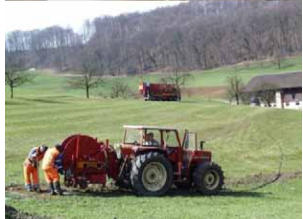
Mittels eines speziellen Spülkopfes können Ablagerungen in den Leitungen gelöst werden. Zur Vermeidung von Bodenverdichtungen oder Schäden an den Drainagen sollte nicht mit dem Spülfahrzeug selbst auf den Boden gefahren werden (siehe S. 6, Bewirtschaftung). Ist die Reichweite des Spülfahrzeuges nicht ausreichend, kommt daher ein Traktorhaspel als Verlängerung zum Einsatz. (Quelle: Marquis AG Kanalservice)
