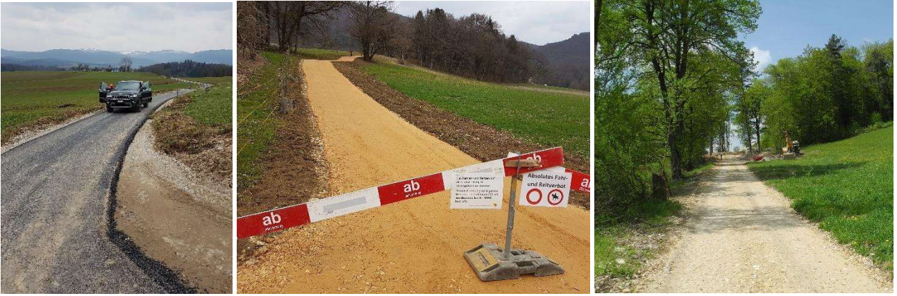
Sanierung Hofzufahrt Kleinblauen, Ausbau Wege im Usserfeld und im Gebiet Hintersteimel, Etappe 5 (Fotos: Ebenrain)
