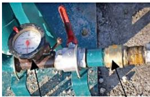
Foto 3: Mechanischer Durchflusszähler mit Anti-Rücklaufventil (G. Fiaux, 2007)
